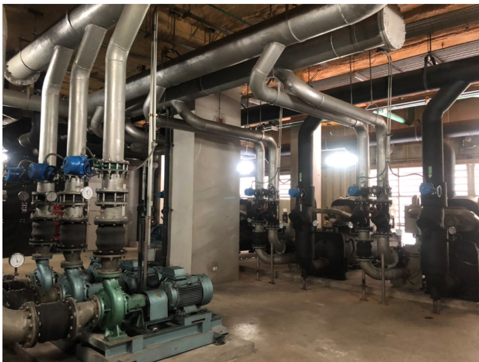
ระบบ Chiller System Management (CSM)
