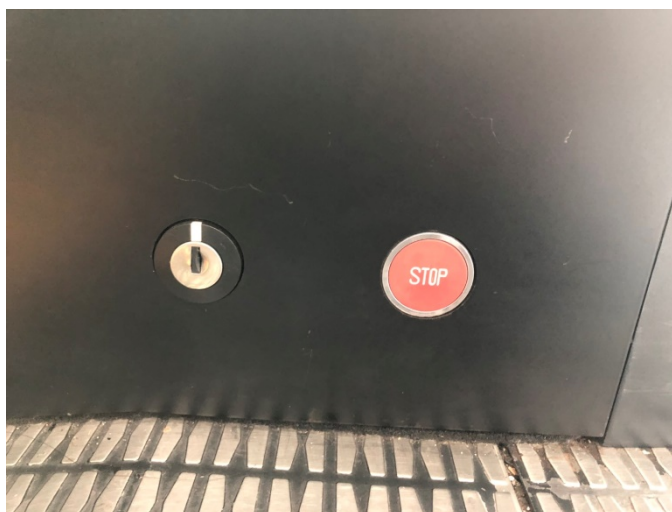
ตำแหน่งเปิด – ปิด บันไดเลื่อน
